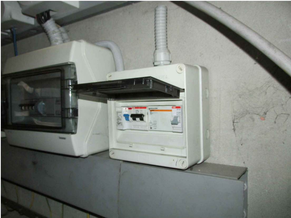
Quadro Q28 - VIA DEL MACELLO
